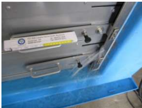
Bild 6.2-3: Starker Wasseraustritt an einer Stelle
