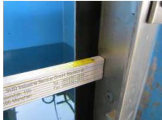
Bild 6.3-8: Wasseraustritt rechte Seite
