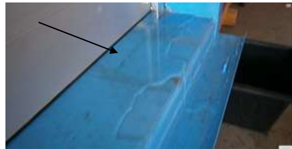
Bild 6.3-4: Wasseraustritt bei der Sohlendichtung neben der Mittelstütze
