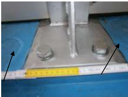
Bild 6.3-3: Wasseraustritt bei der Sohlendichtung neben der Mittelstütze
