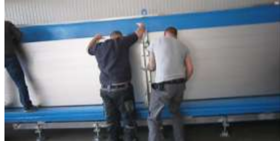
Bild 6.2-8: Fixierung der Dammbalken mittels Vertikalspanner
