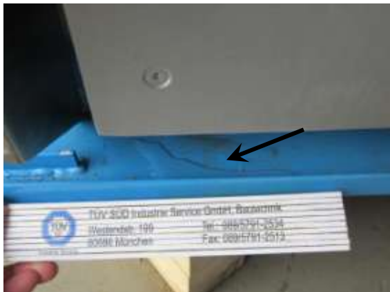
Bild 6.3-3: Bandseitiger Wasseraustritt gering, sehr bildet kein Rinnsal
