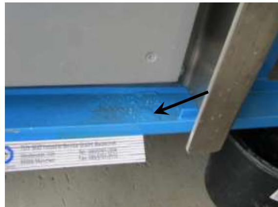
Bild 6.3-4: Riegelseitiger Wasseraustritt gering
