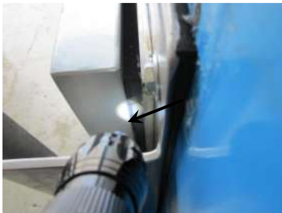
Bild 6.2-5: Riegelseitiger Wasseraustritt obere rechte Ecke (Gehrungsstoß nicht sauber)
