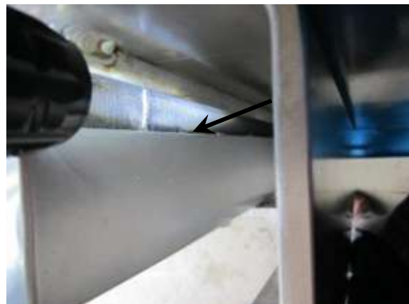
Bild 6.2-6: Riegelseitiger Wasseraustritt gering
