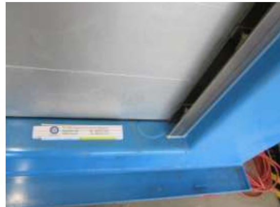
Bild 6.3-2: Wasseraustritt in den Ecken der Sohlendichtung / U-Aufnahme
